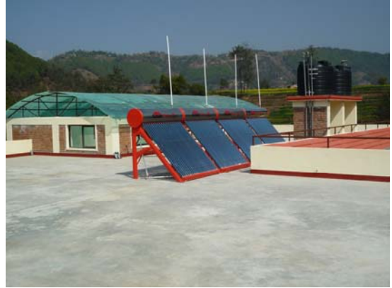
.. . Solar für die Warmwasseraufbereitung
