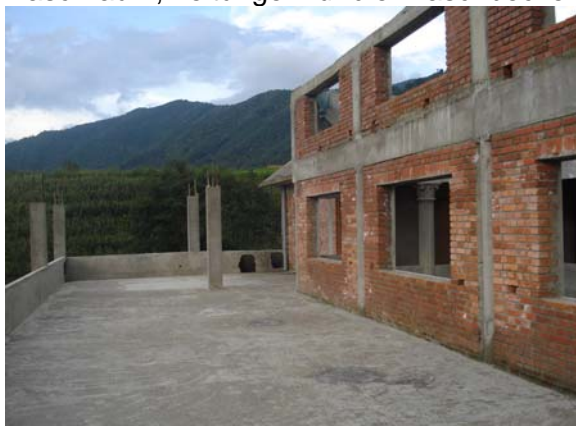
Hinten li. wird eine Trockenstelle für die Wäsche errichtet. Es fehlt noch die Überdachung
