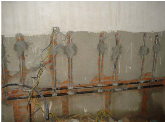
Waschraum, Leitungen für die Waschbecken
