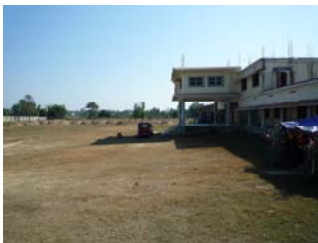
...mit der Anlieferung von Sand für das Drainage System hat man bereits begonnen
